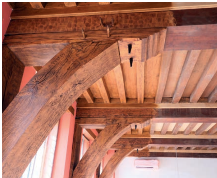
De spanten en plafondbalken waren verkleurd geraakt door de tand des tijds en worden bijgekleurd met een impregneerbeits
